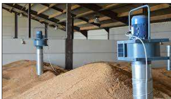
Colonnes de ventilation et vis point chaud
