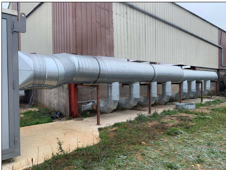
Collecteurs d'air avec planchers perforés carrossables
