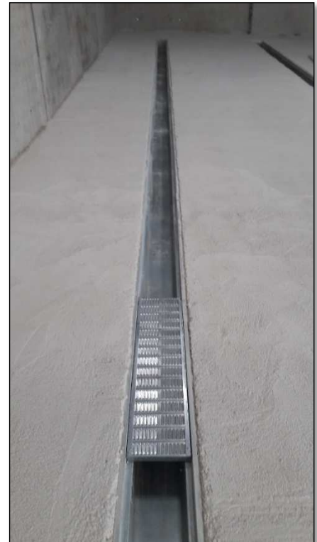
Caniveaux de ventilation
