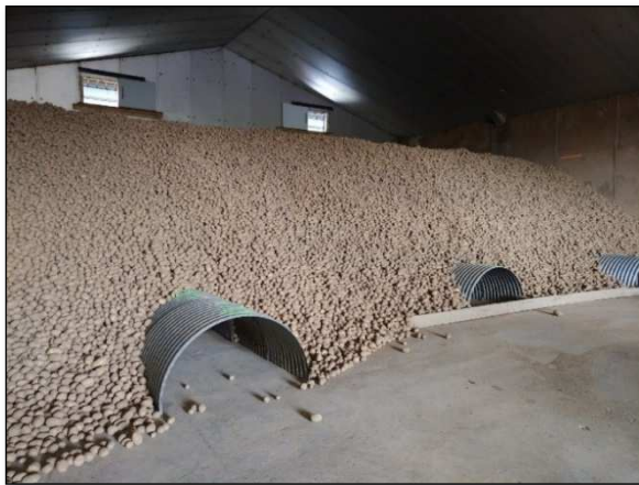
Ventilation pommes de terre par gaines
