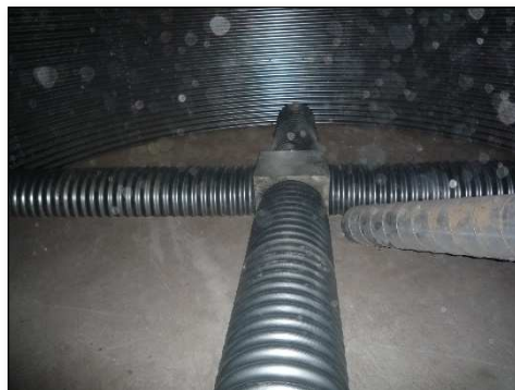
Ventilation par gaines hors sol
