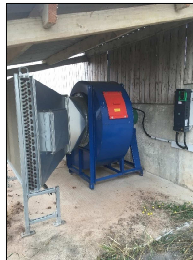
Ventilateurs, batteries chaudes, variateurs de fréquence
