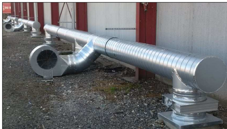
Collecteurs d'air avec ventilateurs centrifuges
