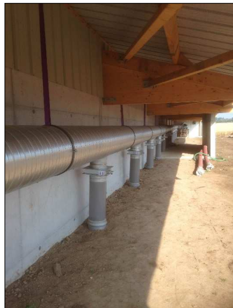
Collecteurs d'air avec caniveaux de ventilation
