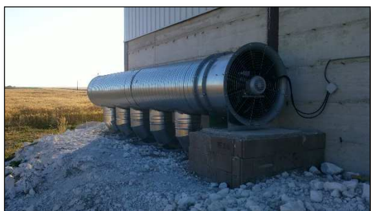
Collecteurs d'air avec ventilateurs axiaux
