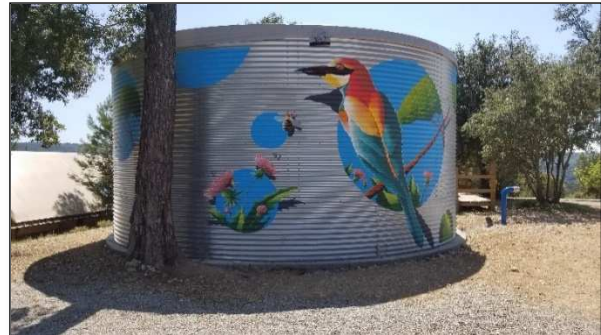
Réserves et colonnes incendie
