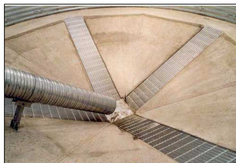
Ventilation par caniveaux
