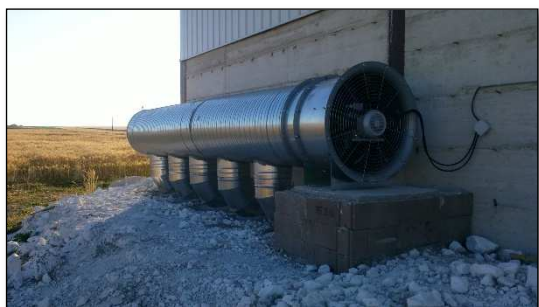
Collecteurs d'air avec ventilateurs axiaux
