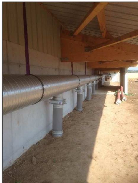
Collecteurs d'air avec caniveaux de ventilation
