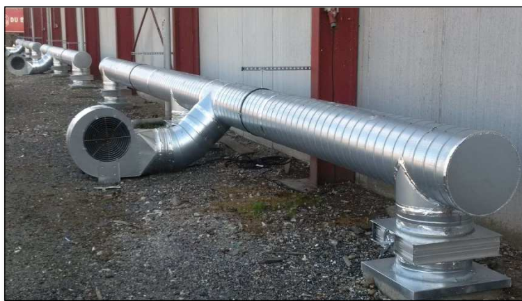
Collecteurs d'air avec ventilateurs centrifuges
