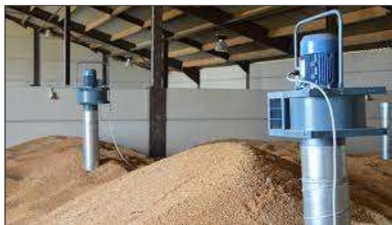
Colonnes de ventilation et vis point chaud
