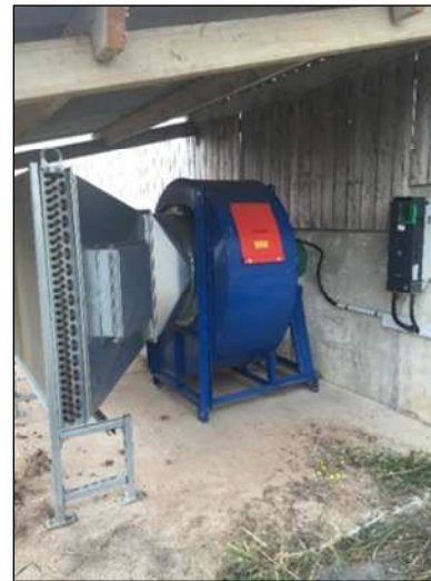
Ventilateurs, batteries chaudes, variateurs de fréquence
