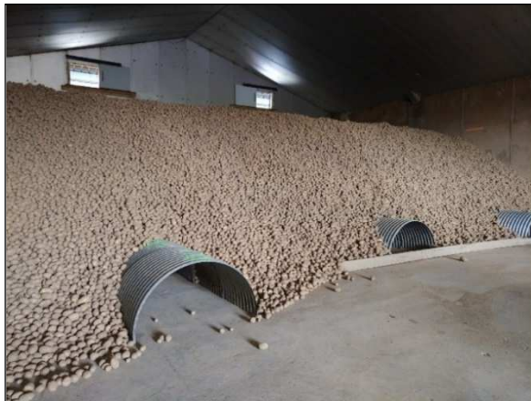
Ventilation pommes de terre par gaines
