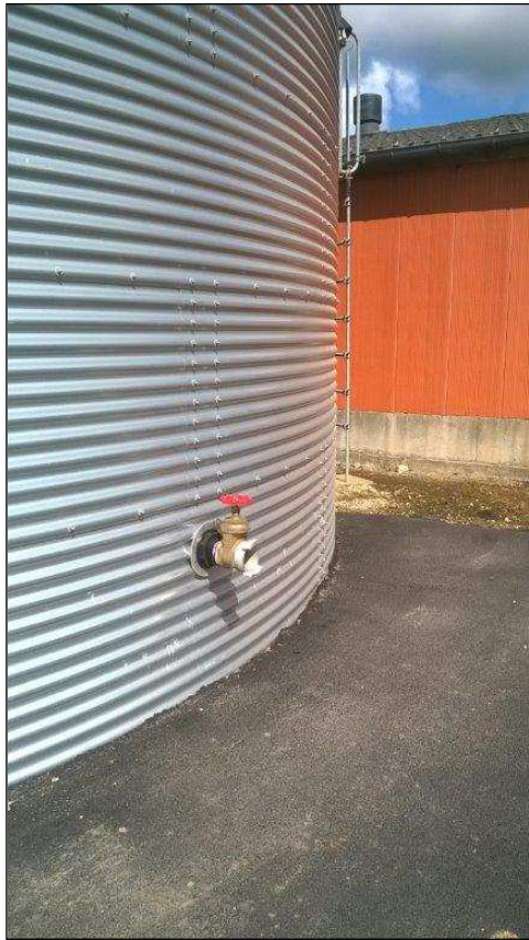
Réserves incendie (sortie directe)
