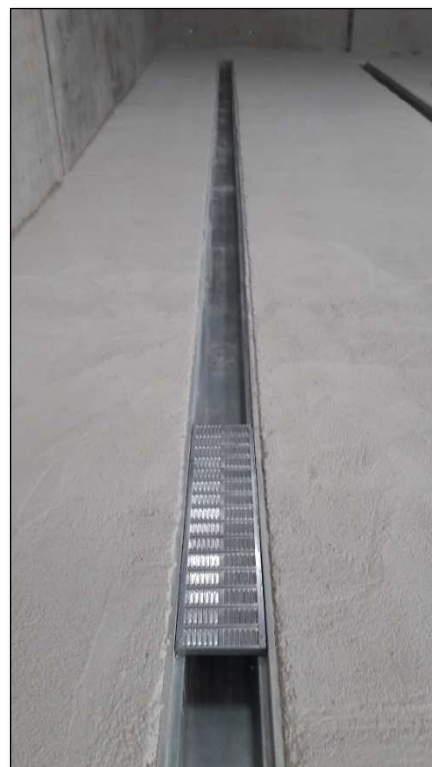
Caniveaux de ventilation
