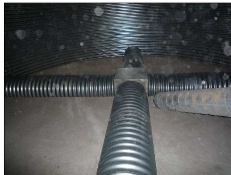
Ventilation par gaines hors sol
