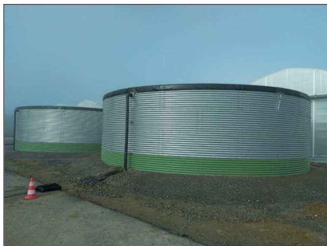
Réserves d'eau semi enterrée
